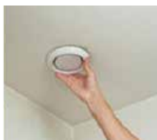
Ventiel mechanische ventilatie
